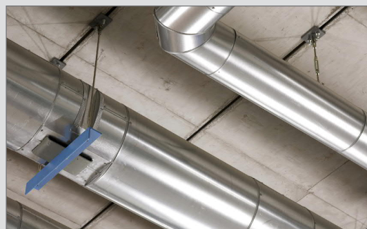
Veiligheidsrelevante aan- en afvoerleidingen in kernreactoren
