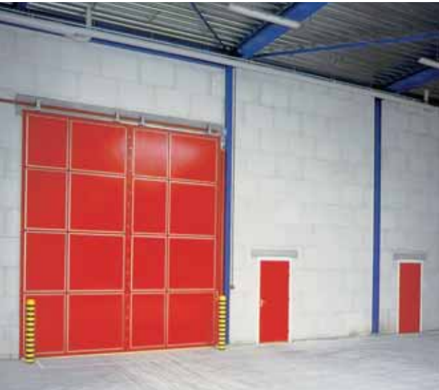
Toepassing van kalkzandsteen elementen als brandscheidende wand in bedrijfshal.
